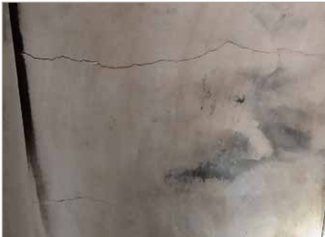
Abb. 33: Beispiel Riss in der Innenauskleidung
